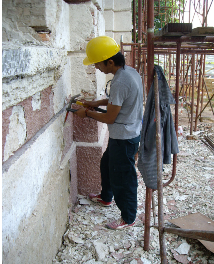
Foto 7: Kerja-kerja penggantian batu bata baru dan memecahkan lepaan yang rosak Sumber: Projek Pemuliharaan HSBC, Melaka, 2009
