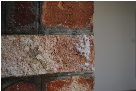
Foto 10: Kesan penggaraman pada permukaan diinding Sumber: Projek Konservasi Fasad Bangunan Sultan Abdul Samad, 2009
