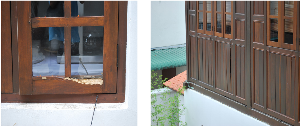
Foto 15: Kecacatan pada tingkap akibat serangan anai-anai dan papan meleding Sumber: Projek Pemuliharaan Sanitary Board, Perak, 2008
