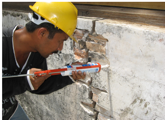
Foto 8: Kerja-kerja "Stapling" pada permukaan dinding untuk mengukuhkan struktur Sumber: Baikpulih Rumah Penghulu Natar, Merlimau, Melaka, 2009
