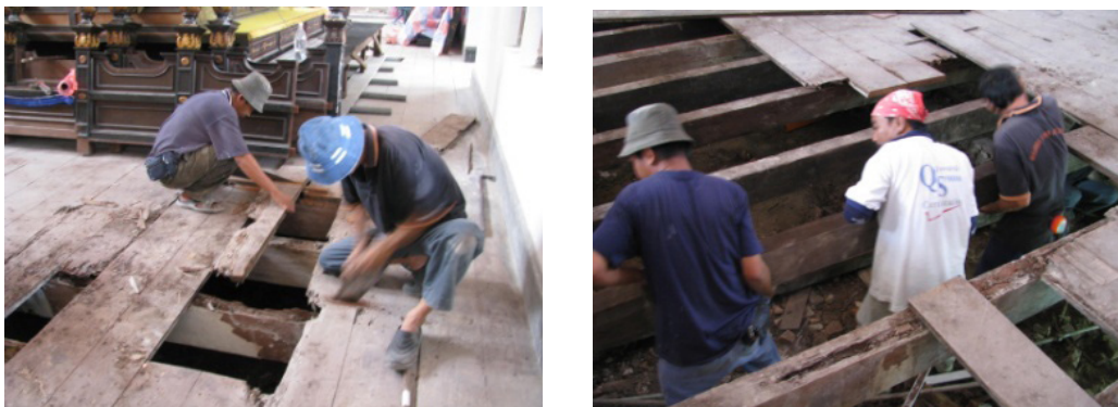
Foto 12: Kecacatan utama pada lantai adalah pereputan kayu akibat serangan anai-anai. Gambar kiri dan kanan; kerja-kerja mengeluarkan papan lantai dan gelegar lantai yang rosak Sumber: Projek Pemuliharaan Muzium Perak, Taiping, 2008
